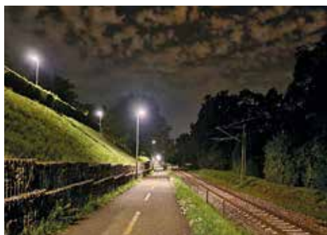
Beleuchtungssituation Rüchliweg Riehen
