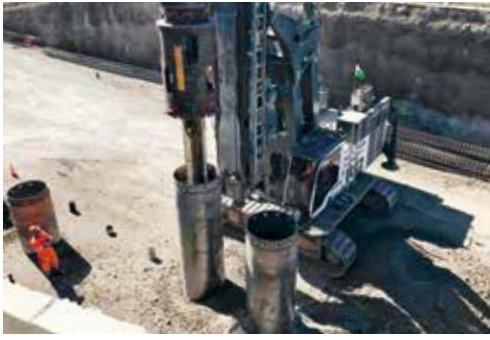
Ein 110-Tonnen-Bohrer bereitet das Fundament für die gedeckte Schneise der SBB-Linie in Lutry vor.
